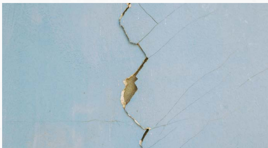
Putzbedingte Schäden lassen sich mit relativ geringem Aufwand beseitigen. Bei konstruktionsbedingten Rissen gestaltet sich die Sanierung schwieriger.
