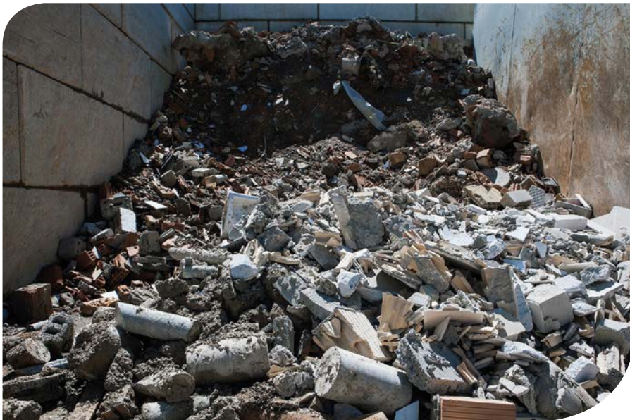
Als deponiepflichtige Baurestmassen werden bei Loacker Recycling u.a. angenommen: Gipskartonplatten und -verschnitte, ausgehärteter Zement, Mörtel, Beton, abgeschlagener staubiger bröseliger Putz, abgeschabte Wandfarbe, Schlacke wie Schlackesteine und Fußbodenschüttungen, Verbund-Fassadenplatten, Abdichtungs- und Isoliermaterial, Glas, Sand & Kies.
